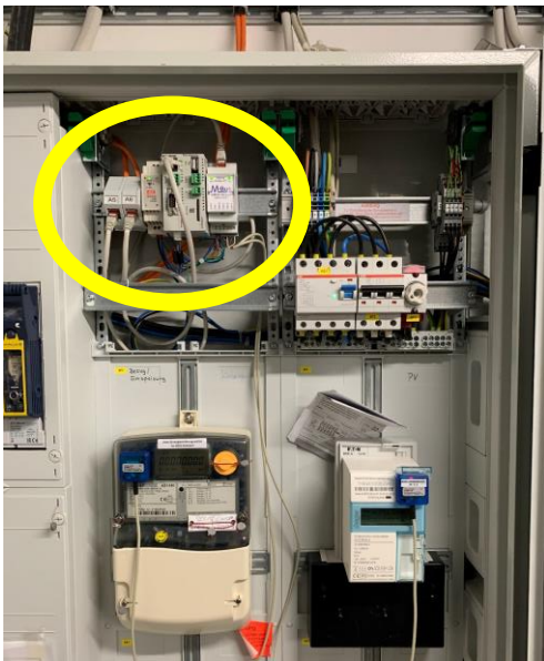
Beispiel: Eingebaute SEKS-Station im Zählerschrank
